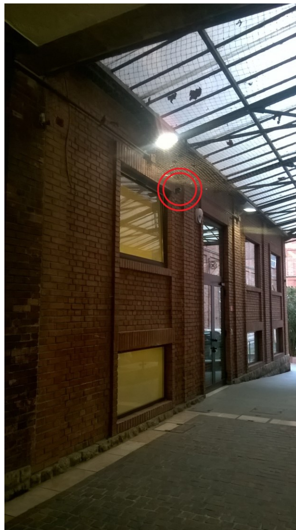
Telecamera a destra dell'ingresso dell'utenza
